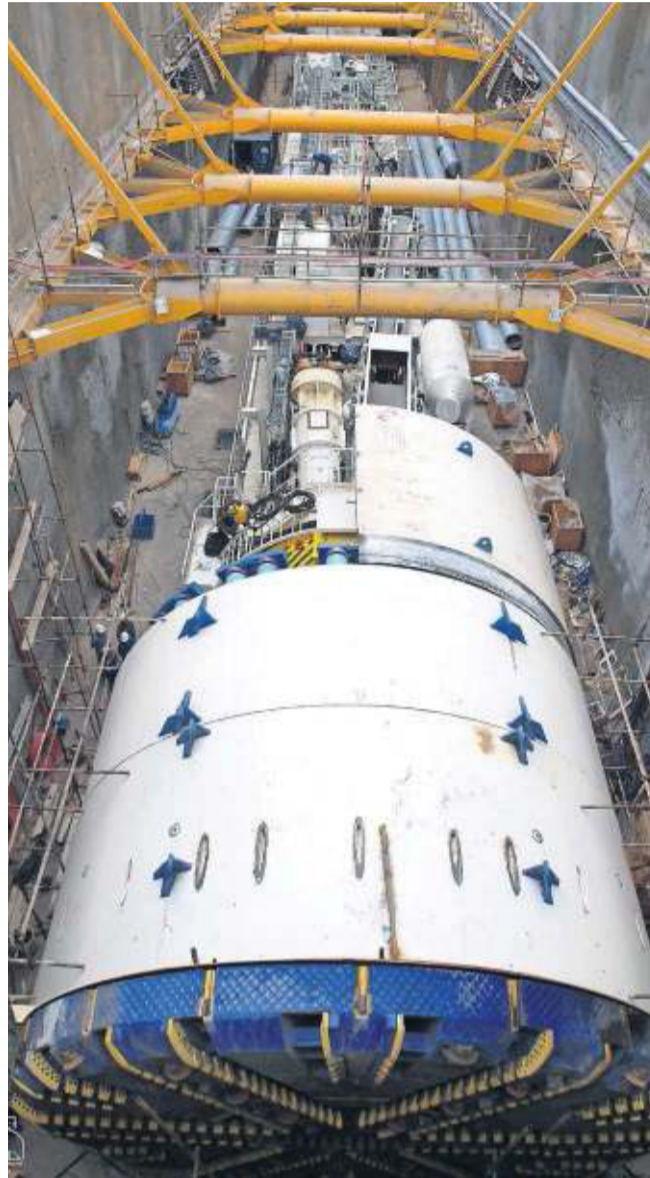
De startschacht van de te boren tunnel voor de tweede metrolijn van Mashhad. Arthe maakte het volledig ontwerp van boortunnel en ondergrondse verbindingen en begeleidde de acquisitie van de TBM en segmentkisten. Foto's: Arthe CS
